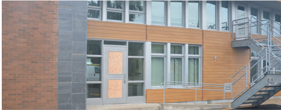
Les portes extérieures en verre trempé ont été fracturées. Photo : Maxime Paradis
