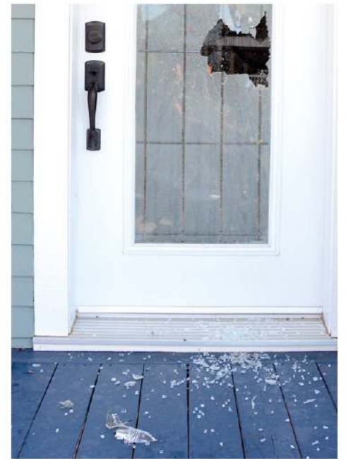
Sur la photo à droite, dommages à la porte d'Hélène Royer. Photo : Maxime Paradis.
