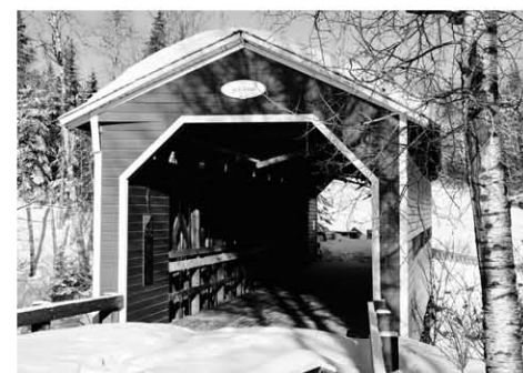
Le pont couvert de Saint-Onésime a subi des dégâts importants à sa structure. Photo : Maxime Paradis.
