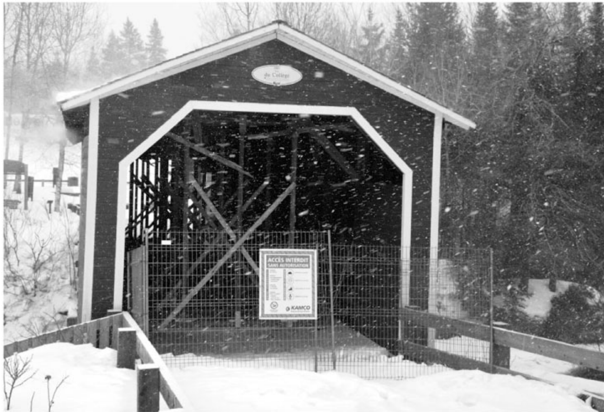
La structure intérieure du pont couvert a été renforcée, en attendant les travaux qui le remettront en état. Photo : Maxime Paradis.
