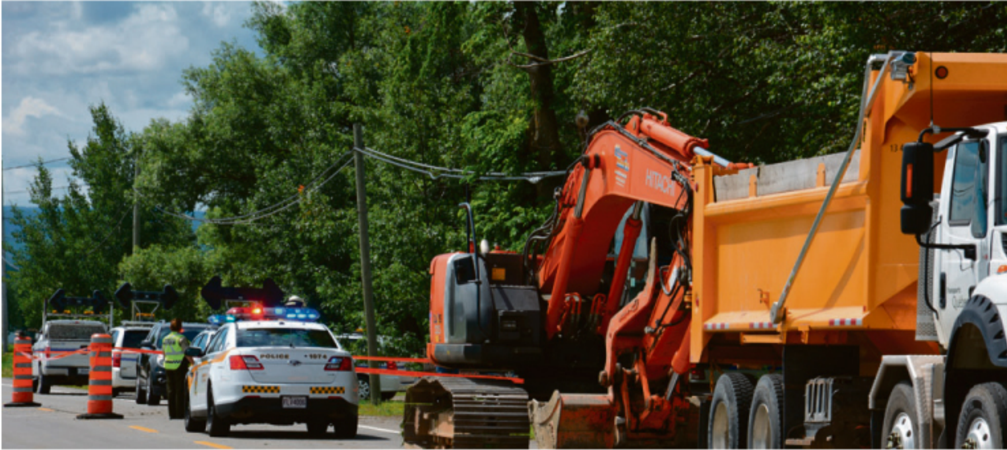
L'incident est survenu sur un chantier de l'avenue de la Grande Anse à La Pocatière. Photo : Maxime Paradis.
