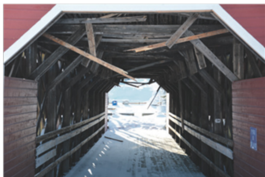
La structure du pont couvert abîmée. Photo : Maxime Paradis.
