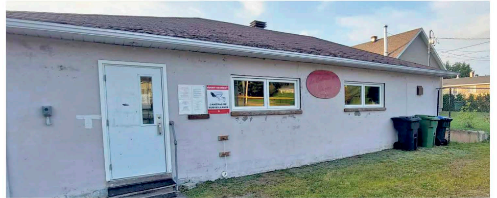
À la suite d'une inspection par un spécialiste attiré à ce type de vérification, la décision de construire une nouvelle bâtisse a été prise par le conseil municipal de Mont-Carmel. Photo : José Soucy
