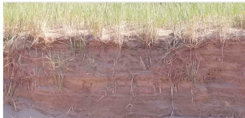
Les marées de plus en plus fortes et l'absence de glaces causent des problèmes d'érosion côtière importants. Photo : Marc Larouche
