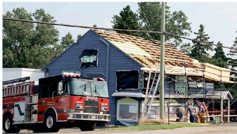
Le feu a pris naissance dans l'entretoit, mais on ignore encore s'il est lié aux travaux en cours sur la toiture de l'édifice. Photo : Éliane Vincent
