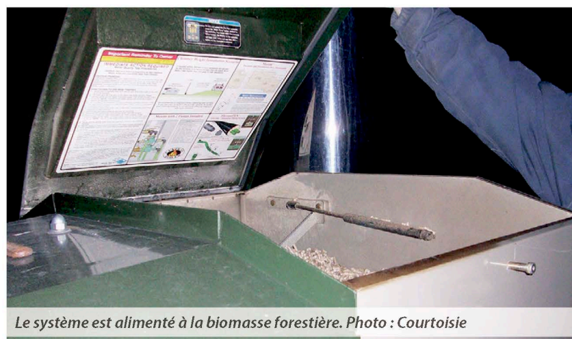
Une première chaudière a été installée stratégiquement entre l'église et l'école. Photo : Courtoisie
