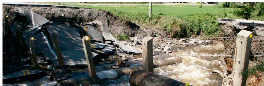
L'érosion des berges peut causer des dommages aux infrastructures routières. Photo : Marc Larouche
